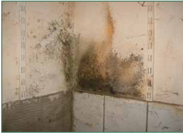
Hoeken van ongeïsoleerde buitenmuren zijn gevoelig voor schimmel. Bron: VIBE
